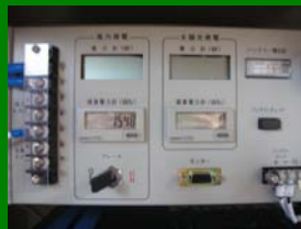
蓄電機(トイレ室内に設置)
